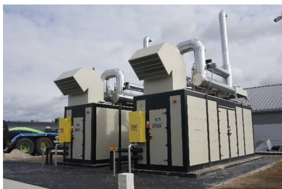
Rys. 3. Kogeneratory w MEB 1,0 MW e w Michalowie Kolonii.
