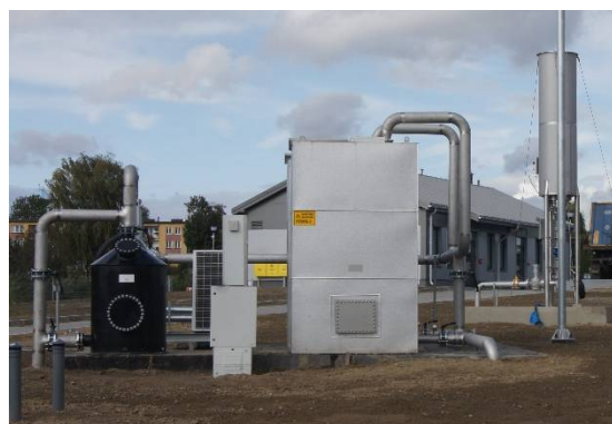
Rys. 4. Instalacja oczyszczania biogazu w MEB 1,0 MW e w Michalowie Kolonii
